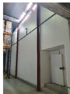
フーデックス社フランス・ブルージュ冷凍冷蔵庫
