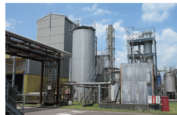
黒壁蔵焼酎粕飼料化設備
